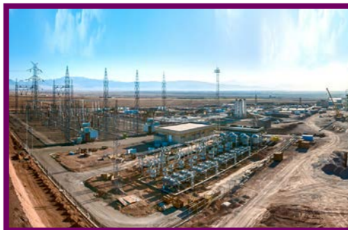
مجموعه پست ۴۰۰/۲۳ و SVC مجتمع فولاد بردسیر
