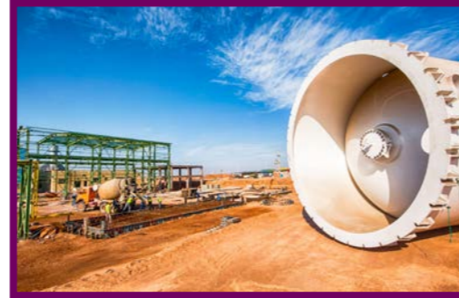
بخش اول برج جداکننده کارگاه اکسیژن
