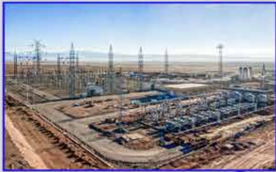
پست برق ۴۰۰ KV
