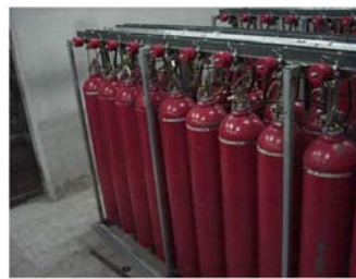
اتاق CO 2 سالن رنگ شماره ۲ ایران خودرو مشتمل بر ۱۶۰ عدد سیلندر اطفاء حریق گاز CO 2
