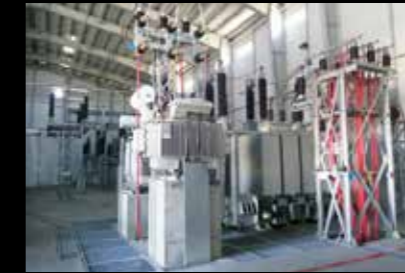
پست برق ۲۰ / ۱۳۲ کیلوولت Indoor اسکان
