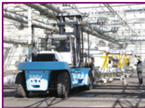
▲ نصب خط AF240 خط ماشینکاری بلوک سیلندر
