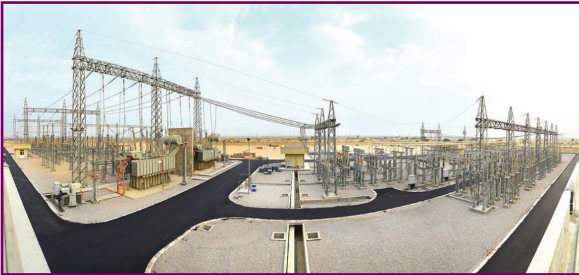
▲ نمای کلی پست برق 230/63KV
