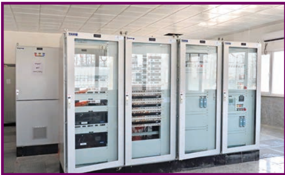
▲ تابلوهای کنترل و اندازه‌گیری
