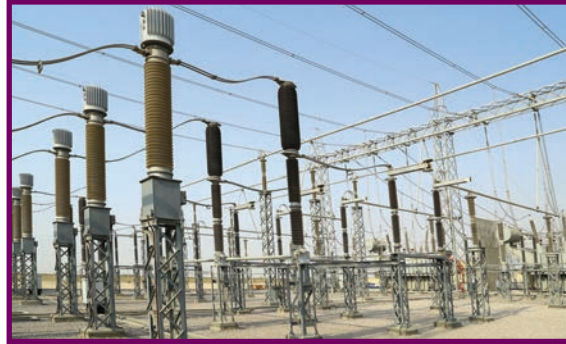
▲ تجهیزات فشار قوی ۲۳۰ کیلو ولت
