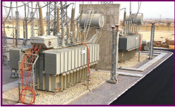
▲ ترانسفورماتور قدرت 230/63KV, 125MVA
